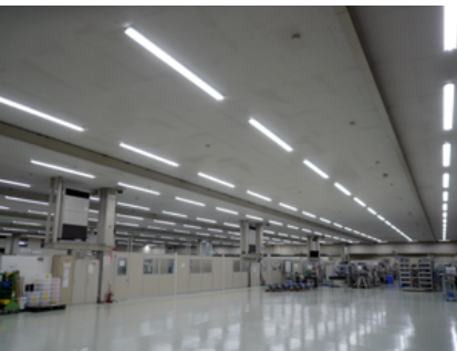
工場の LED 照明
