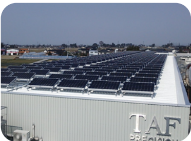
太陽光発電システム
